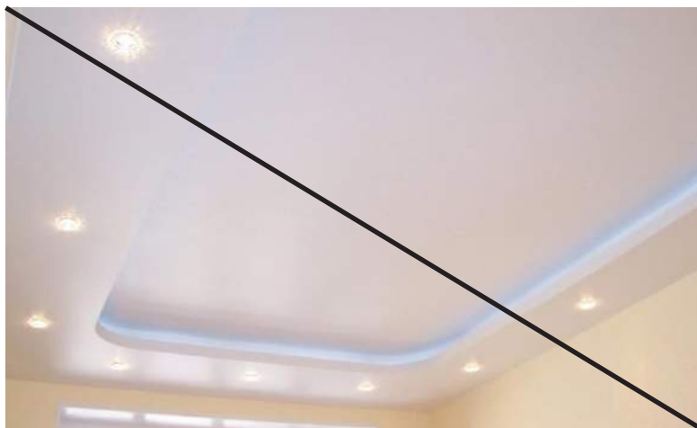
Плохо Многоуровневые гипсокартонные конструкции
