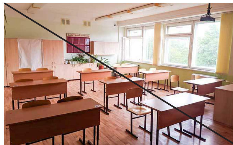
Плохо Линолеум под дерево
